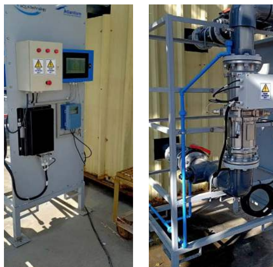
Figura 3: Instalación de skid UV HOD™ con equipo RZ 163-11 HP, 2.3 kW
